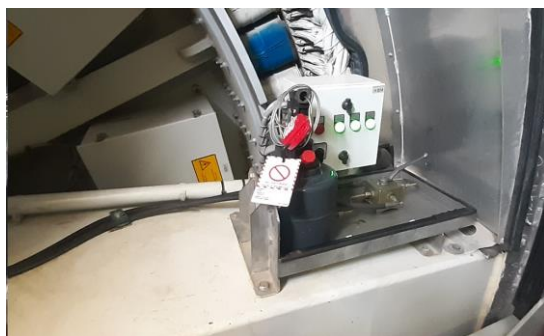
Bomba manual bloqueada mediante trabado de sirga y candado LOTO. Manual pumping locked by cable device and LOTO padlock.
