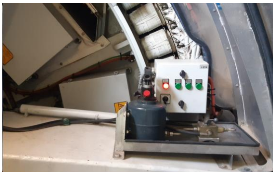
Bomba manual sobre el bastidor del rotor. Manual pumping on the rotor frame.
